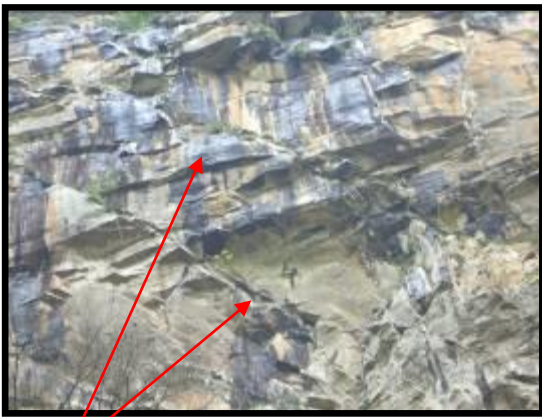
Infiltrações da água da chuva (em preto) além das fissuras provocadas pelo resfriamento.
